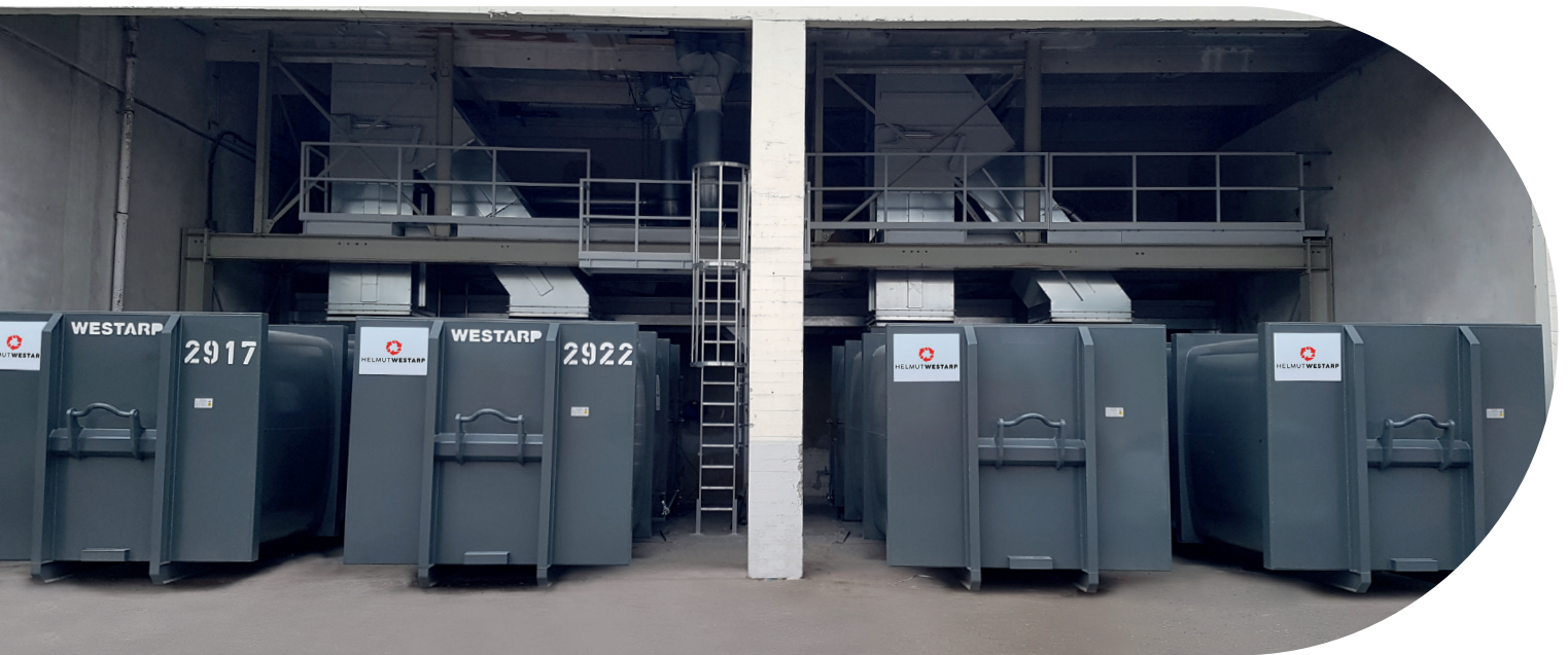
Press-Station mit Absauganlage
