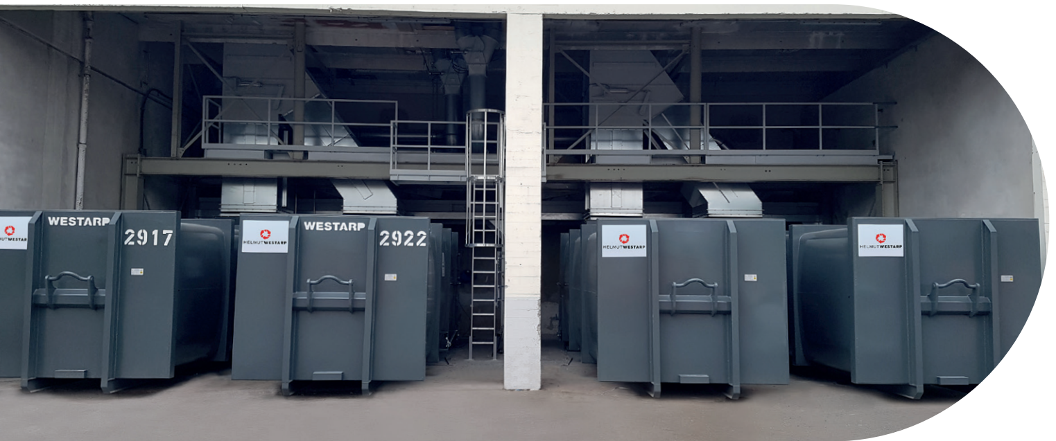
Press-Station mit Absauganlage
